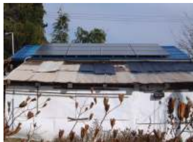
* 太陽光発電を設置された物置
